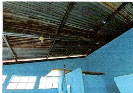
Foto 2: La siguiente imagen nos muestra el deterioro del techo que cubre el espacio para los servicios sanitarios.
