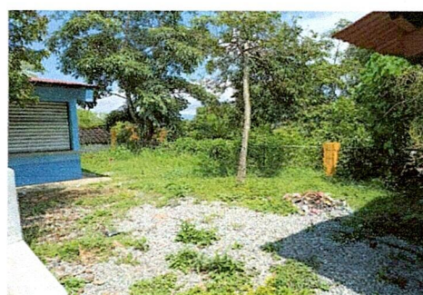
Foto 4: Imagen que nos muestra el lugar en donde se ha deteriorado y tapado la fosa séptica, por lo tanto es necesario la remodelación de la misma.
